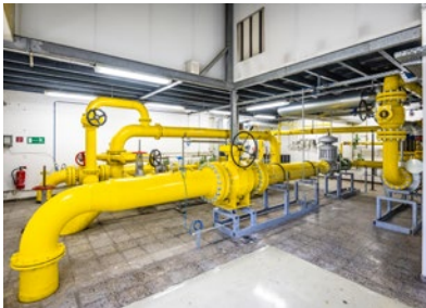
Am Netzkopplungspunkt erfolgt die Übergabe des Gases der OGE an die enm. Anschließend wird das Gas im Netzgebiet der enm weiterverteilt.
