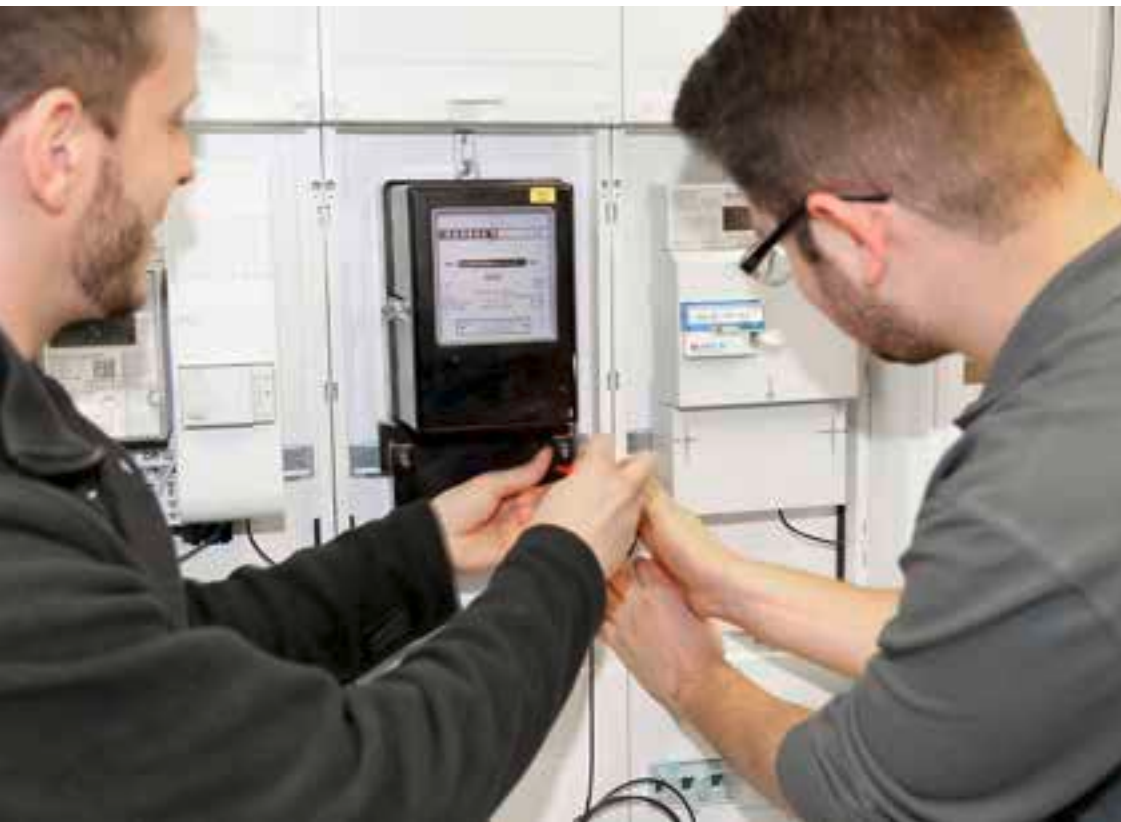
Bestens gerüstet: An einer Testwand bereiten sich die Mitarbeiter der enm auf den breit angelegten Zählertausch bei den Kunden vor.
