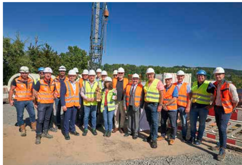
Großes Interesse beim Pressetermin: Zahlreiche Medienvertreter und kommunale Partner informierten sich auf der Baustelle, Anlass war die Tunneltaufe.
