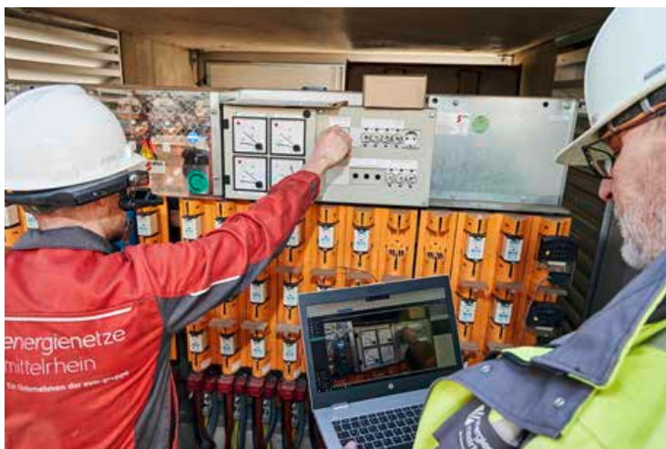
Bernhard Hofer (links) und Ewald Kerber von der enm testen die Einsatzmöglichkeiten für die RealWear-Datenbrille an einer Trafostation.
