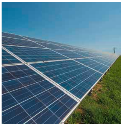
Grüner Strom von nebenan: Mit evm-RegioStrom unterstützen Kunden regenerative Anlagen aus der Region.
